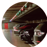
SEEPARK sistema interno di guida al parcheggio
